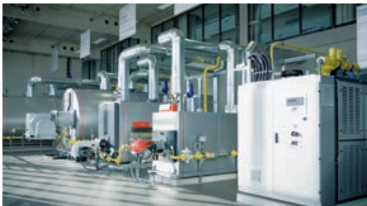
Энергоцентр в г. Аллендорф
