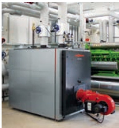
Системы отопления, работающие на биогазовом топливе представлены в энергоцентре Viessmann
