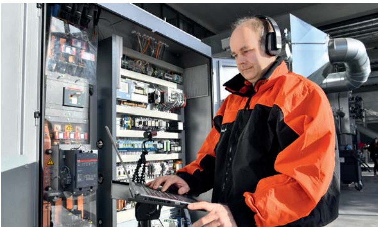
Serviceeinsatz an einem Blockheizkraftwerk. Dabei kann sich der Techniker zur Unterstützung in Bild und Ton mit der Zentrale verbinden.
