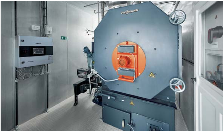
Der Biomassekessel Vitoflex 300-RF leistet 540 kW.
