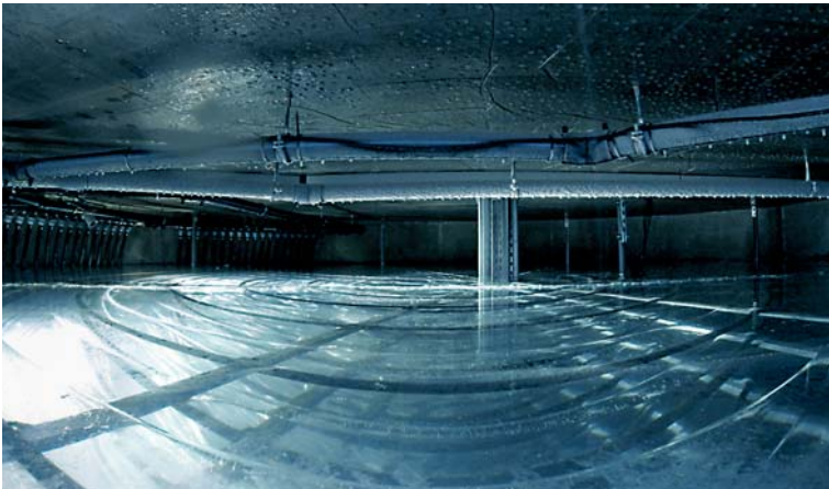
Blick in das Innere eines individuell gebauten Eisspeichers – hier im vereisten Zustand.
