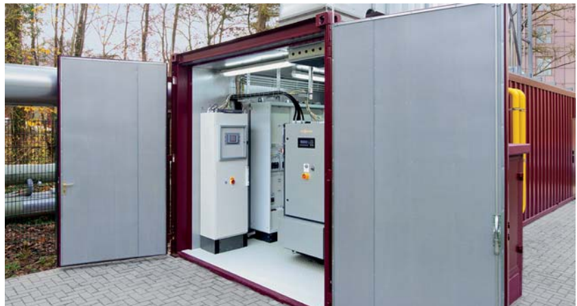
Rückseite des Containers mit Schaltschrank Vitocontrol (links). Die Vitobloc 200 leisten je 140 kW el und 207 kW th .
