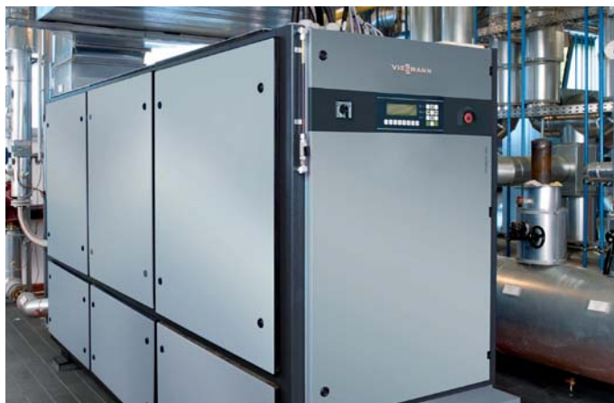
Versorgt das St. Augustinus Krankenhaus mit Wärme und Strom: Vitobloc 200
