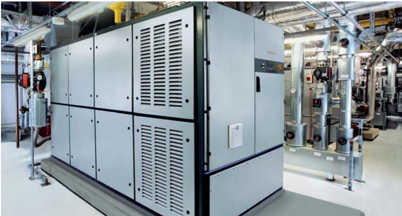
Blockheizkraftwerk Vitobloc 200 mit Leistungen von 238 kW el und 363 kW th
