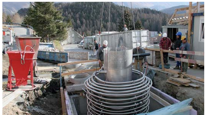
Dieser Abwasserschacht dient als Primärquelle zur Warmwasseraufbereitung.
